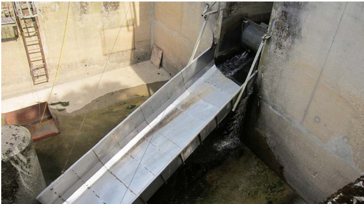
Klappe im abgesenkten Zustand
