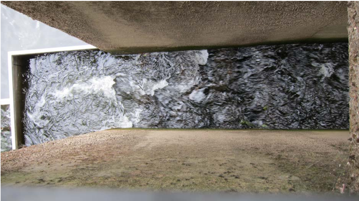
Blick von oben in den Fischpasseinschnitt, am linken Bildrand Übergang in Metall-Verlängerung (Fließrichtung im Bild von rechts nach links)
