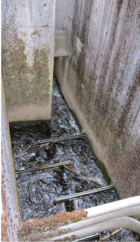
Fischpass-Bereich mit größerer Lichtweite, Blick in Fließrichtung
