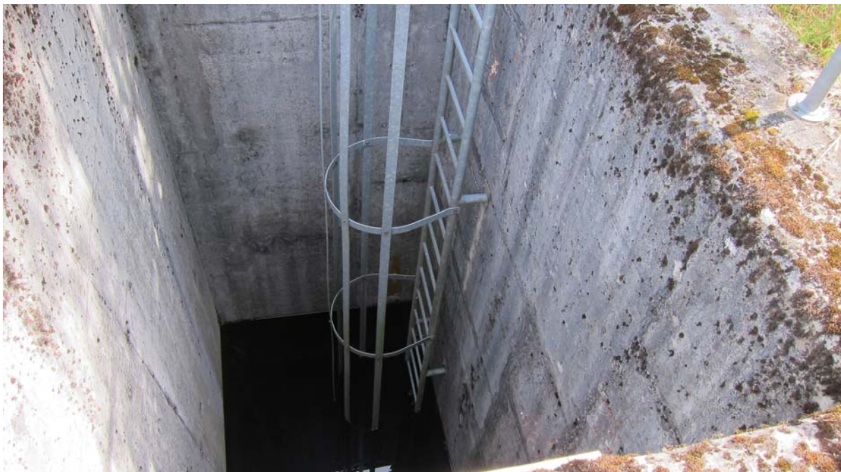
Abstieg in Schieberschacht am linken Rand der Anlage, von dort verlaufen 2 Spülleitungen DN 800 zum Ausleitungsgerinne
