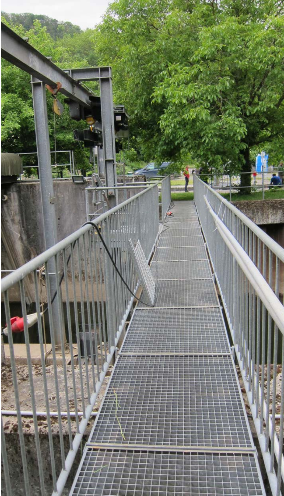
Blick auf Gitterroststeg oberhalb der beiden Einlaufrechen, Fließrichtung im Bild von rechts nach links
