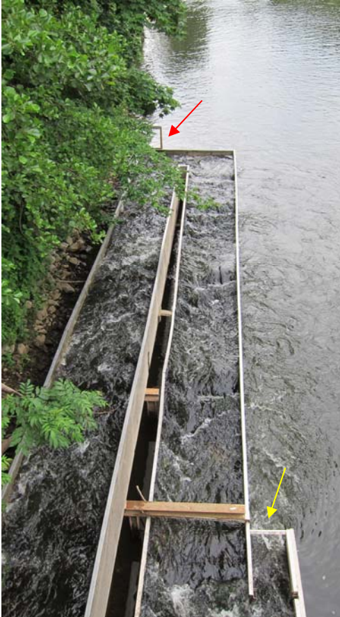
Metallgerinne als Fischpassverlängerung, Blick Richt. Unterwasser (Normaleinstieg aus Unterwasser am gelben Pfeil, bei höheren Abflüssen über freigegebene Schieberöffnung am roten Pfeil)
