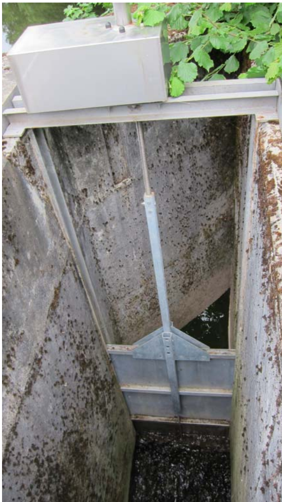
Einlaufschütz am Fischpass, Blick gegen Fließrichtung
