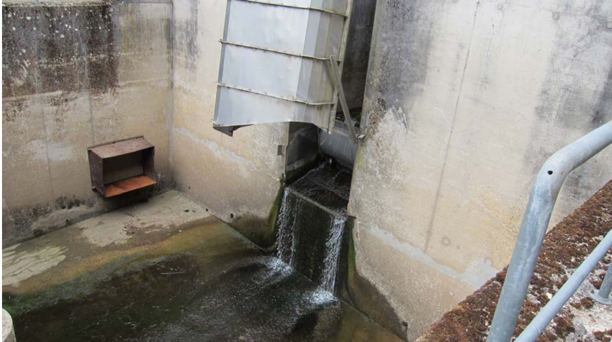
Blick auf mobile Klappe/Rinne, hier gehoben (Senkung für temporären Fischabstieg)
